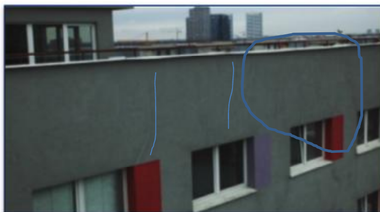
Obr. 3: Trhliny na povrchu zateplenia v miestach pod strešnou atikou [autori]
