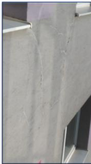
Obr. 5: Stav pretmelenia trhlín na 11. poschodí po 3 rokoch [autori]
