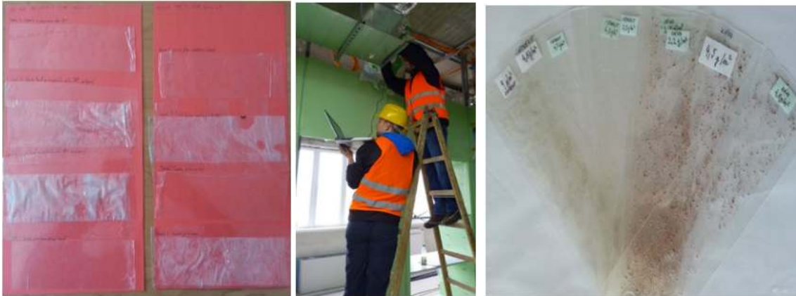
Obr. 5 Ukázka posouzení znečištění potrubního rozvodu vizuální metodou pomocí kontrolního etalonu (vpravo), odebrané vzorky (vpravo)
