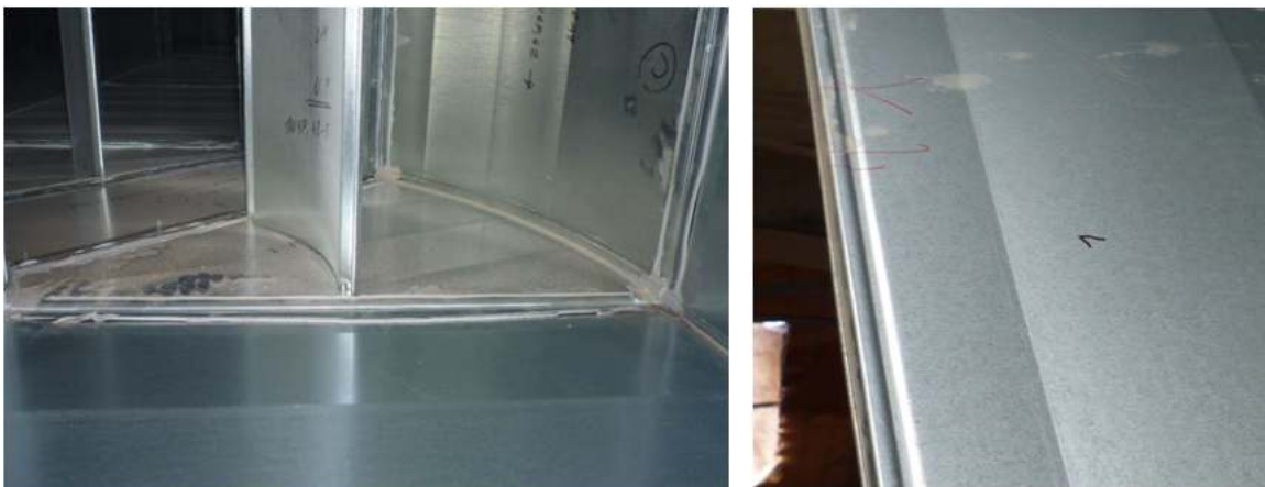
Obr. 2 Ukázka kontaminace vzduchovodu v návaznosti na špatnou ochranu VZT potrubí v čase mezi montáží dvou na sebe navazujících úseků (vlevo), čistota vzduchovodu před montáží (vpravo)
