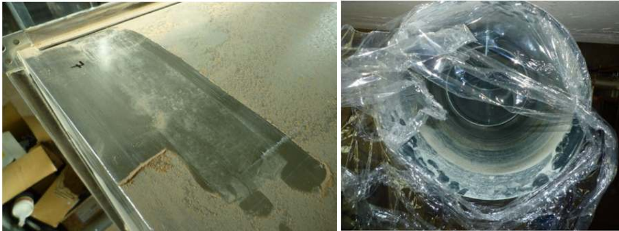
Obr. 1 Ukázka kontaminace vzduchovodů během montáže (na vnější straně – vlevo, na vnitřní straně – vpravo)
