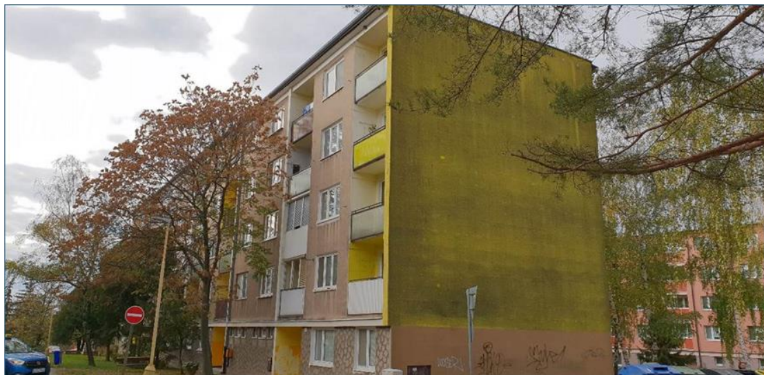
Obr. 2 Pohľad na kontamináciu severnej fasády biokoróziou (autor)
