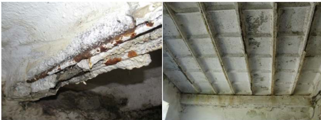
Obr. 2 Degradácia stropných panelov
