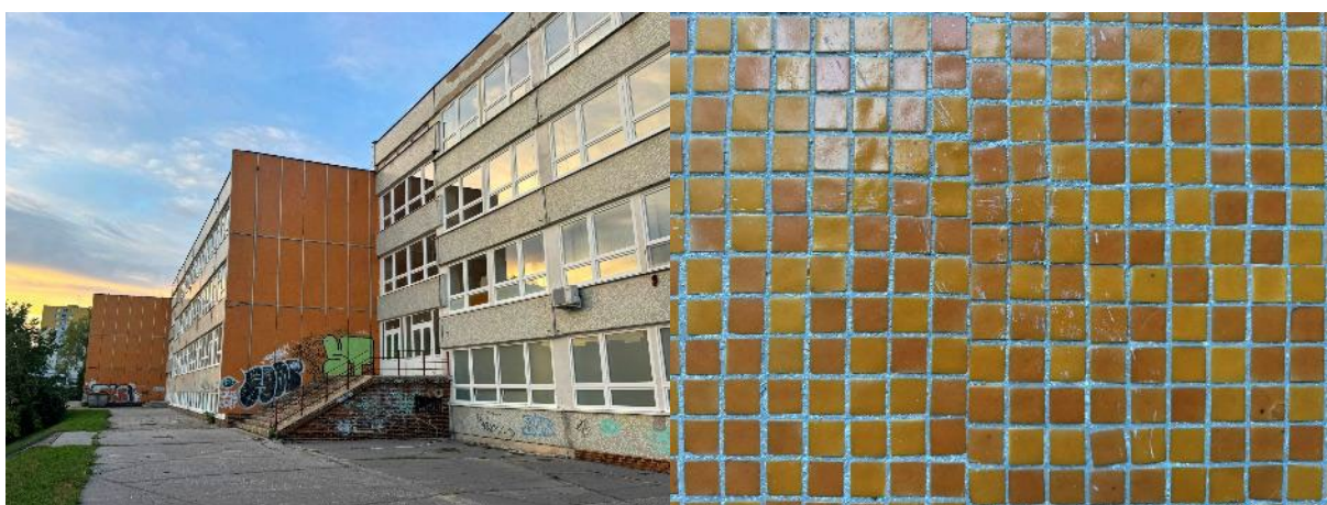
Obr. 9a, b Obchodná akadémia Imricha Karvaša, Hrobákova 11, Bratislava-Petržalka: fasáda a detail štítovej steny ako kompozičného akcentu s chybne osadenými mozaikovými panelmi (foto: Andrej Bisták)
