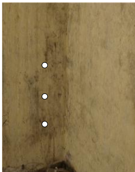
Obr. 2 Detail biokorozívneho napadnutia PP časť RD (archív autora)
