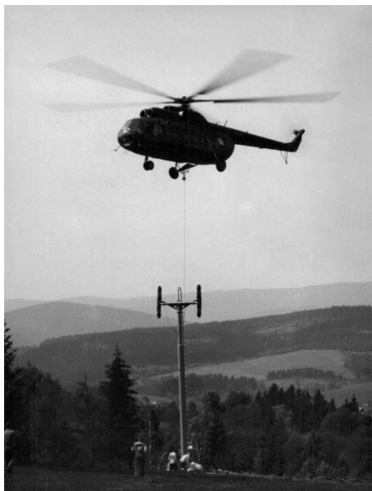
Obr. 2 Montáž rúrových podpier sedačkovej lanovky Špičák – Pancír v Železnej Rude (Miroslav Holub)
